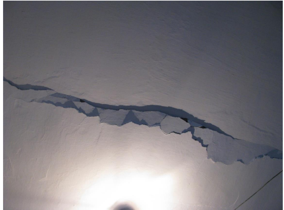
Фото 22. Сквозная трещина в плите перекрытия
