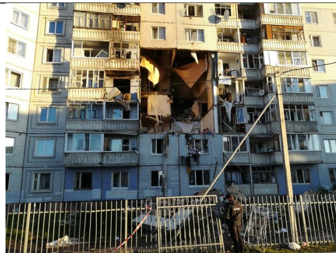
Фото 10. Общий вид повреждений с 3 по 5 этажи на фасаде панельного здания
