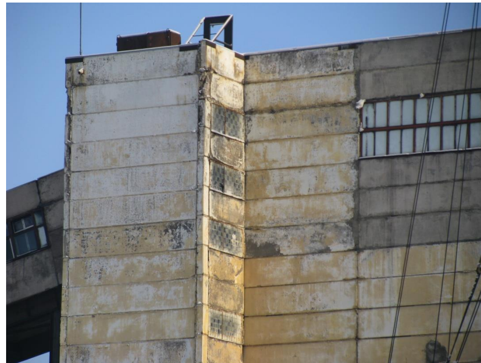
Фото 4. Разрушение железобетонных самонесущих навесных панелей здания котельной
