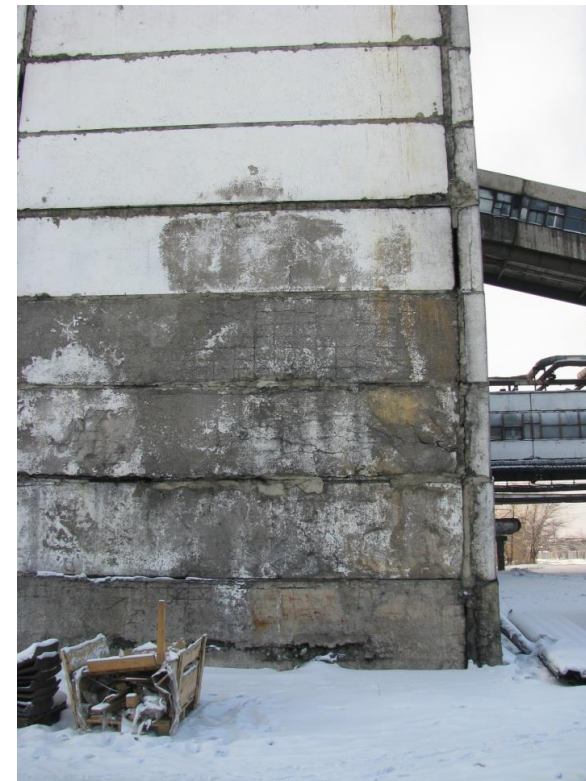
Фото 12. Разрушение железобетонной самонесущей панели здания котельной. Оголение и коррозия арматуры
