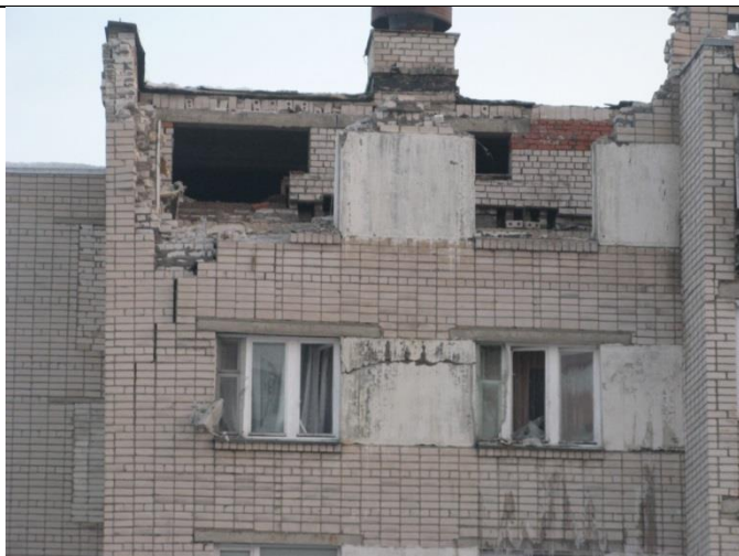
Фото 9. Общий вид поврежденных 4-5 этажей в осях А/11-12. Наклонная и вертикальная трещина на наружной стене кирпичного здания с 5 по 3 этажи
