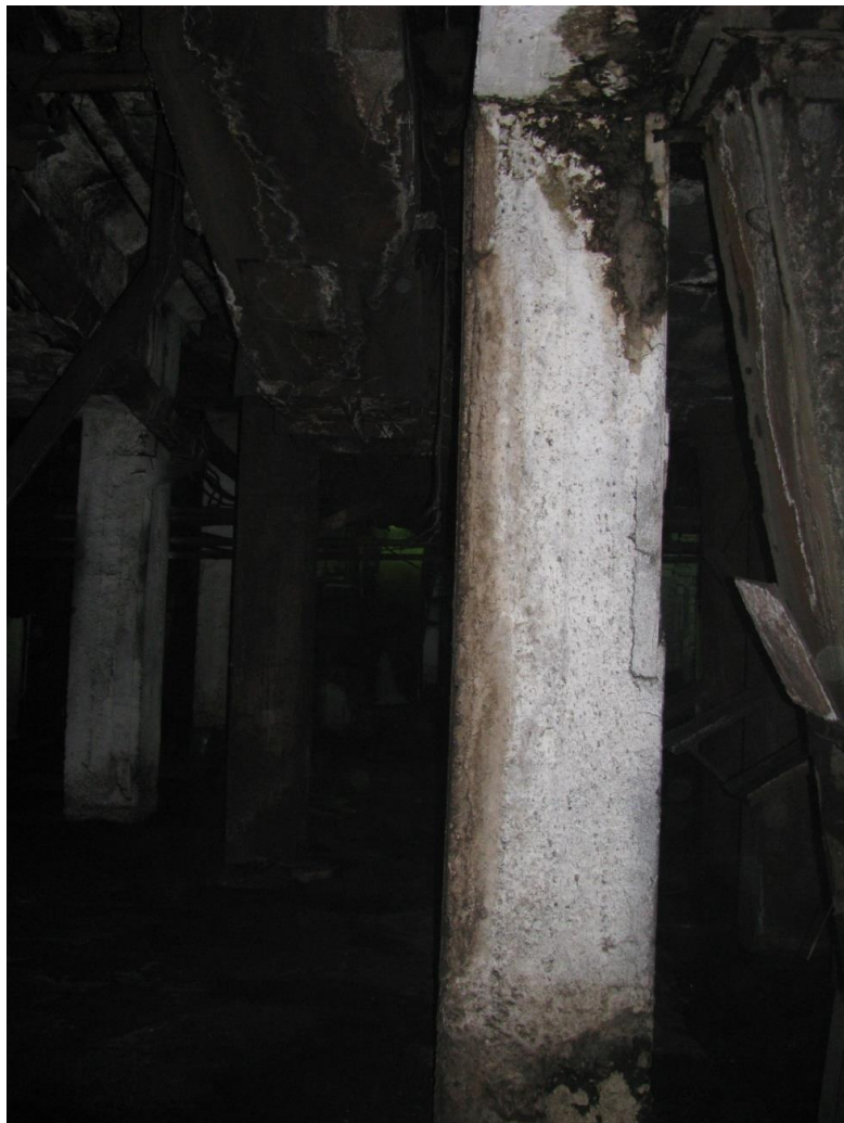
Фото 19. Разрушение защитного слоя бетона, оголение и коррозия арматуры железобетонных колонн
