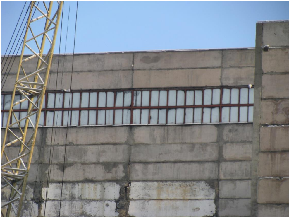
Фото 5. Разрушение железобетонных самонесущих навесных панелей здания котельной
