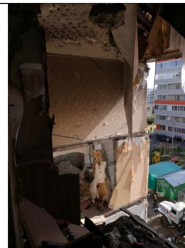
Фото 12. Общий вид внутренних повреждений панельного здания на 8-10 этажах здания
