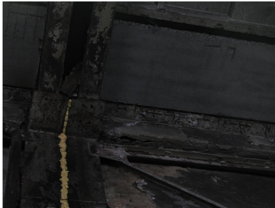
Фото 16. Разрушение защитного слоя железобетонных конструкций, оголения и коррозия металлических конструкций турбинного зала
