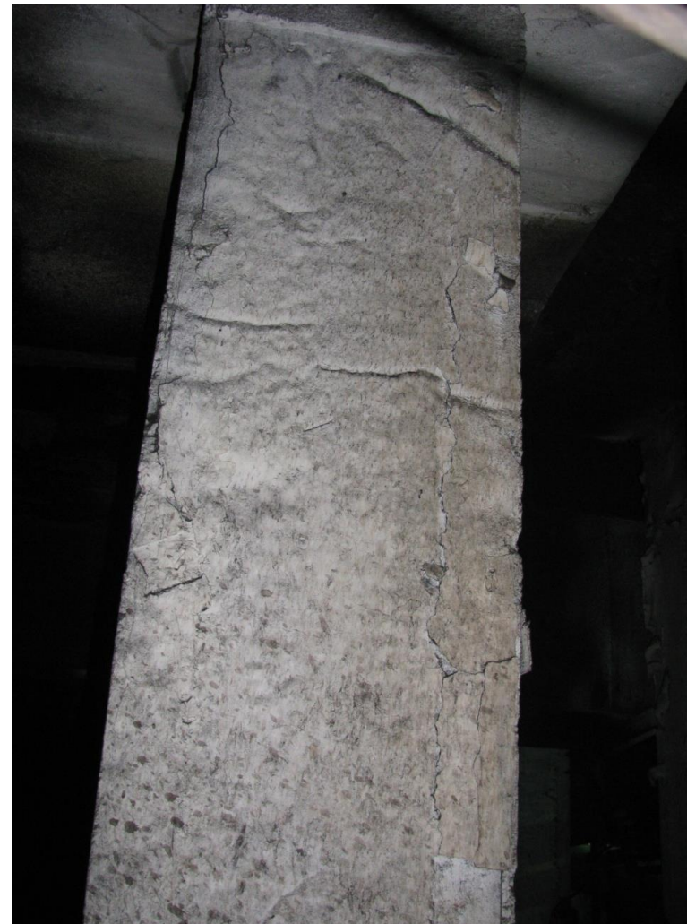
Фото 20. Вертикальная трещина в железобетонной колонне
