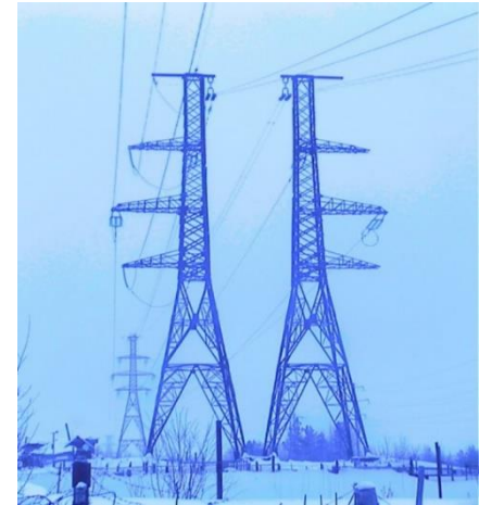
Фото 1.3. Пример башенных сооружений ВЛЭП
