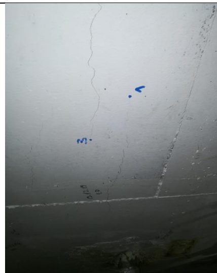
Фото 6. Поперечные трещины длиной до 120 см и шириной раскрытия до 1 мм на плите перекрытия технического подполья здания в осях Гс-Дс/3с-5с
