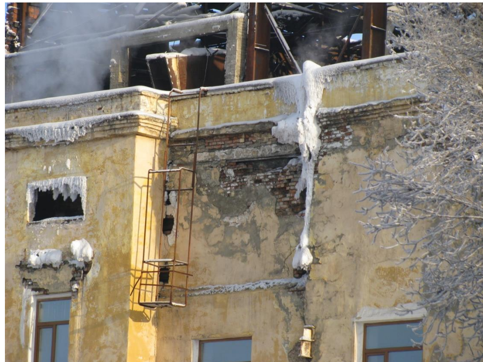
Фото 6. Разрушение штукатурного слоя и кирпичной кладки несущей стены здания турбинного зала
