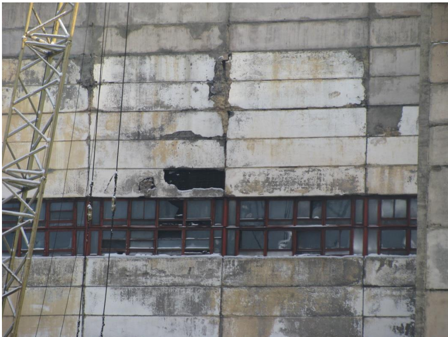
Фото 3. Разрушение железобетонной самонесущей навесной панели здания котельной
