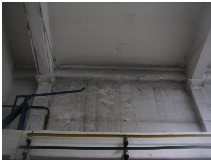
Фото 14. Разрушение подкрановой балки и намокание штукатурного слоя несущей стены турбинного зала
