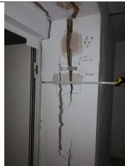
Фото 7. Раскрытие деформационного шва между секциями № 2 и № 3-4 и деформации строительных конструкций технического этажа здания в осях И-К/7с-8с (раскрытие шва составляет до 60 мм, но предположительно до 125мм, см. фото 18)
