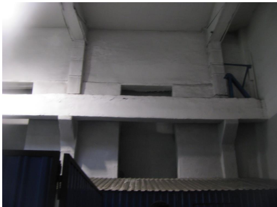
Фото 13. Разрушение подкрановой балки в турбинном зале
