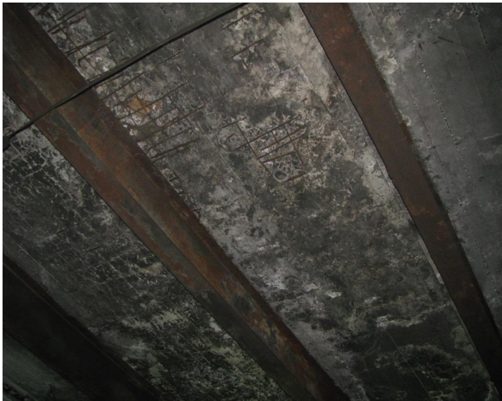
Фото 17. Оголение и коррозия арматуры плит перекрытия
