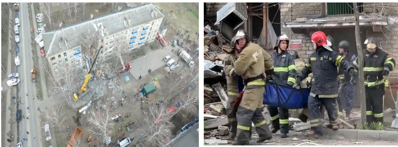
Рис. 1.16. Ликвидация последствий взрыва газозвушной смеси в Московской области
