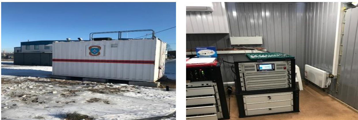
Рис. 6.37. Современная цифровая КВ радиостанция контейнерного типа
